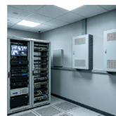
工商业临时供电场景
