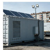
电网侧储能场景
